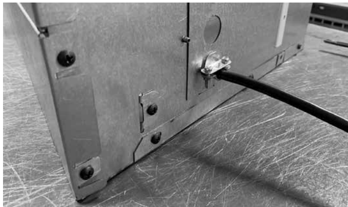
Figure 5.2 Remise en place du couvercle de la boîte de jonction
